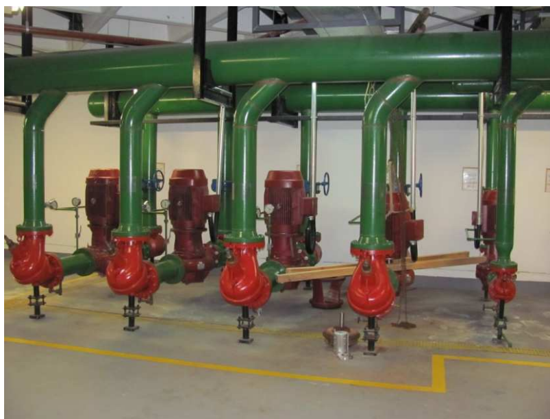
Figura 4 - Bombas de água de condensação
