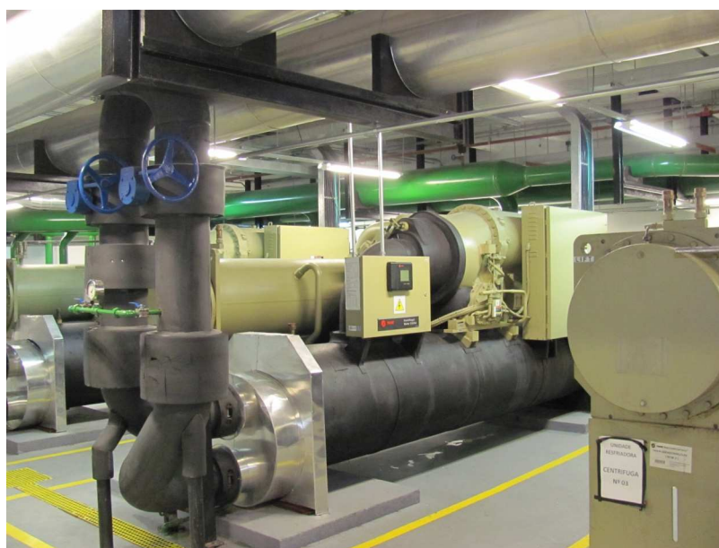
Figura 2 - Central de água gelada (CAG)
