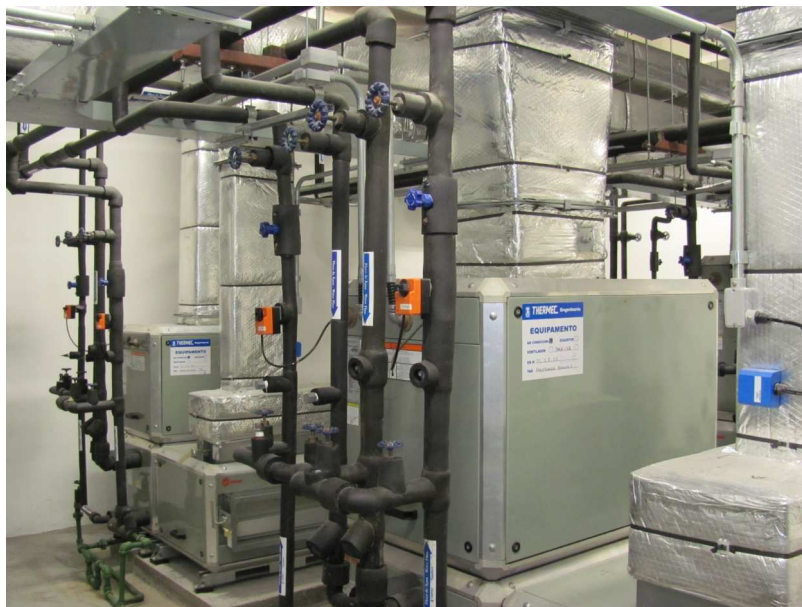
Figura 6 - Condicionadores de ar tipo fancoil convencional
